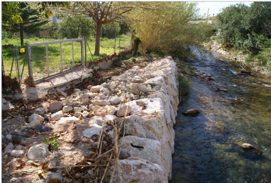
Erosió de camí i escullera crescuda 2020
